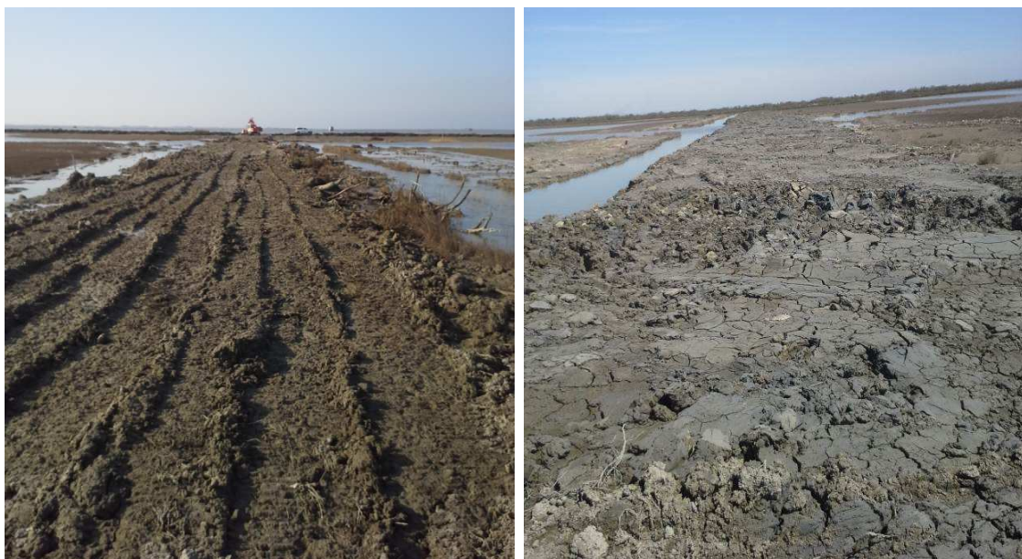
Renforcement de la berge nord de l'ancien salin de la Vignole pour assurer la maîtrise des niveaux d'eau (en décembre 2014 à gauche et à son achèvement à droite en avril 2015).
