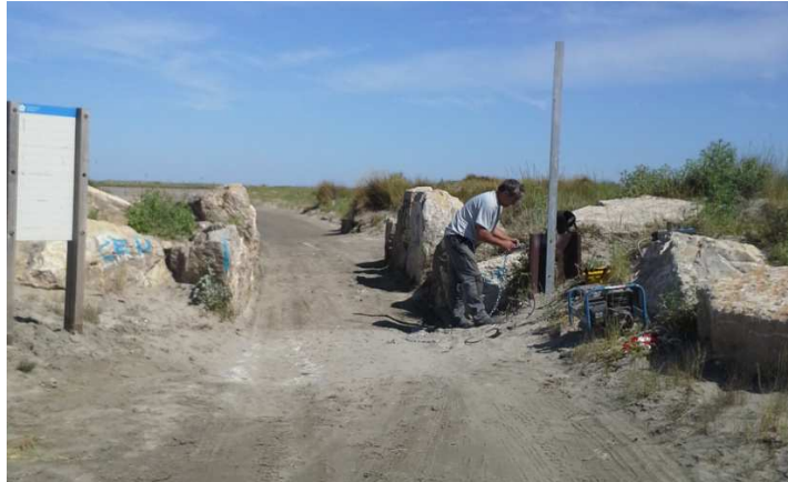
Signalétique et système de fermeture mis en place à l'entrée sud de la plage de la Comtesse au niveau du gabarit en rochers (photo : PNRC).
