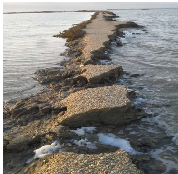
La digue entre Rascaillan et Quarantaine 3 bien érodée (début 2015).
