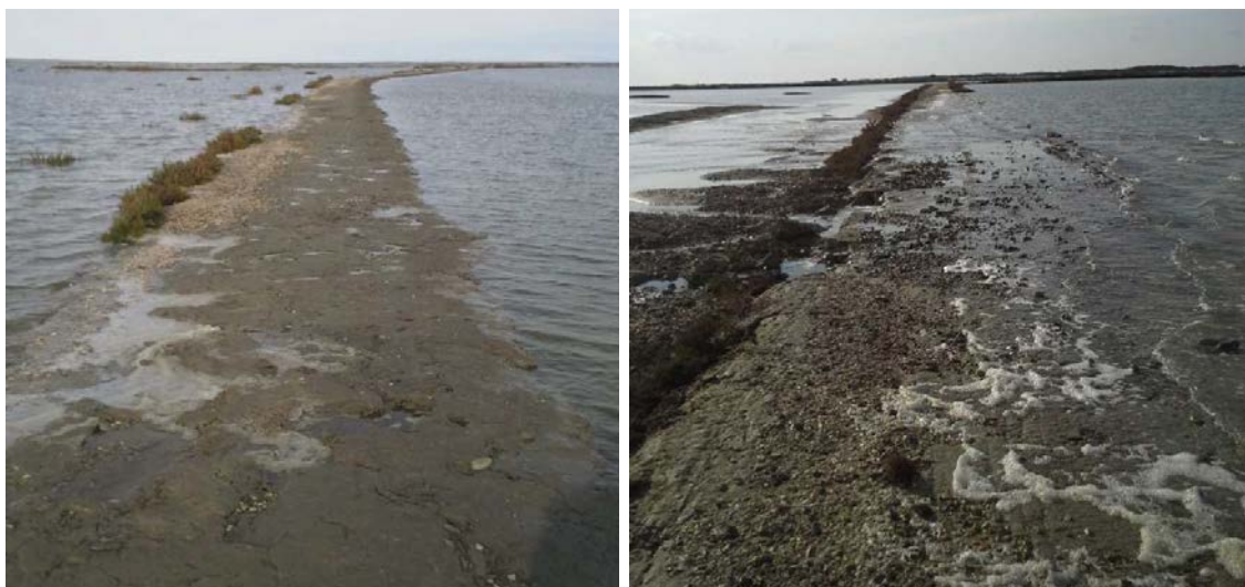
Les digues entre Quarantaine 3 Vaisseau 1 et Pourtour 2 lessivées au cours de l'hiver 2014/2015.
